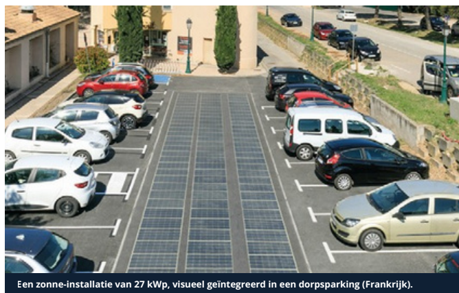
Een zonne-installatie van 27 kWp, visueel geïntegreerd in een dorpsparking (Frankrijk).
